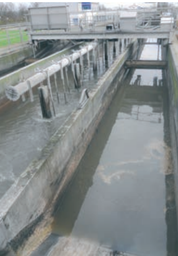
Vandet ledes derefter ud i et anlæg hvor det bliver rensat yderligere for bundfældet sand, og for fedt som flyder op til overfladen.
