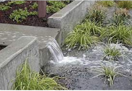
Vandet løbet på terræn på Strædet
